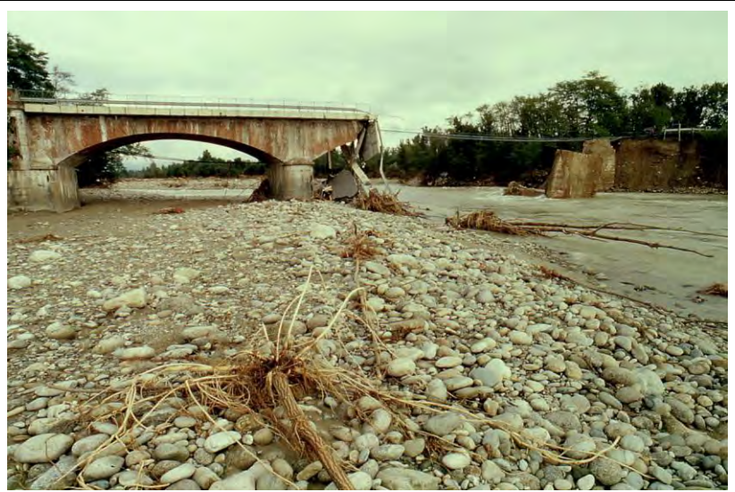
Fig. 2.52 - In occasione delle più intense manifestazioni idrometeorologiche si possono verificare gravi fenomeni di dissesto idrogeologico. In questa immagine si osserva un ponte autostradale sul torrente Malone (in provincia di Torino) in gran parte "spazzato" dall'alluvione del 1992.
